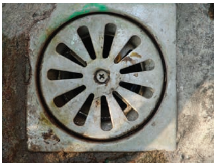
圖6 人造物—排水孔蓋
